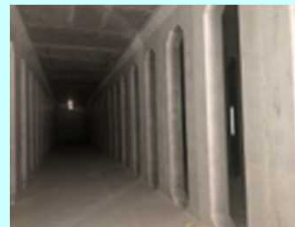
田原本町雨水貯留施設
