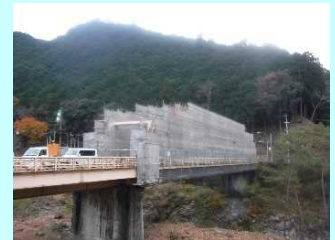
道路施設の老朽化対策
